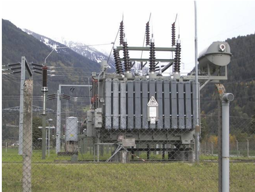
Transformator in typische Freiluft-Schaltanlage
