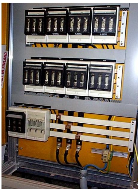
Niederspannungsverteiler mit 5-poliger Anspeisung
